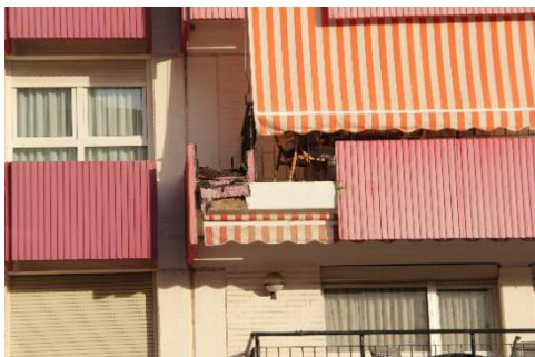
Cas en què el mal estat dels elements prefabricats de formigó ha provocat la seva total desaparició.
