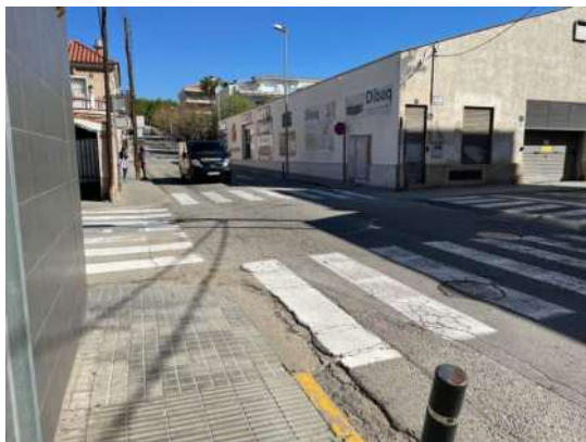
Imatge 46. Cruïlla amb c. Uruguai; asfalt en mal estat, amb terra en calçada (2022)
