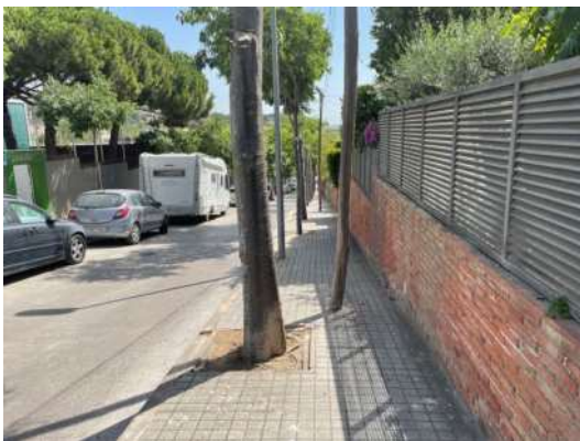
Imatge 86. Vorera amb ample útil reduït per la posició central dels pals de la llum (c. Sant Lluís)
