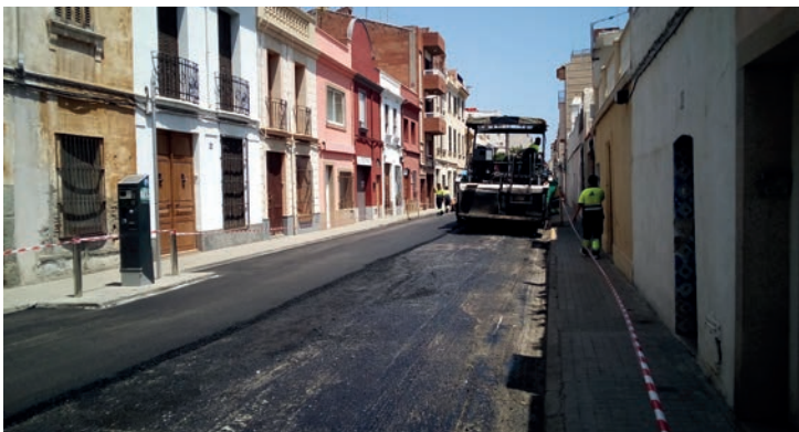
▲ El carrer de Sant Felip és una de les vies on es renova el ferm. CEDIDA
