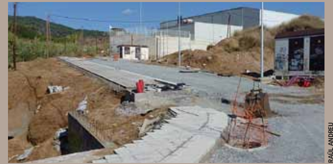
Una zona del sector afectat.
