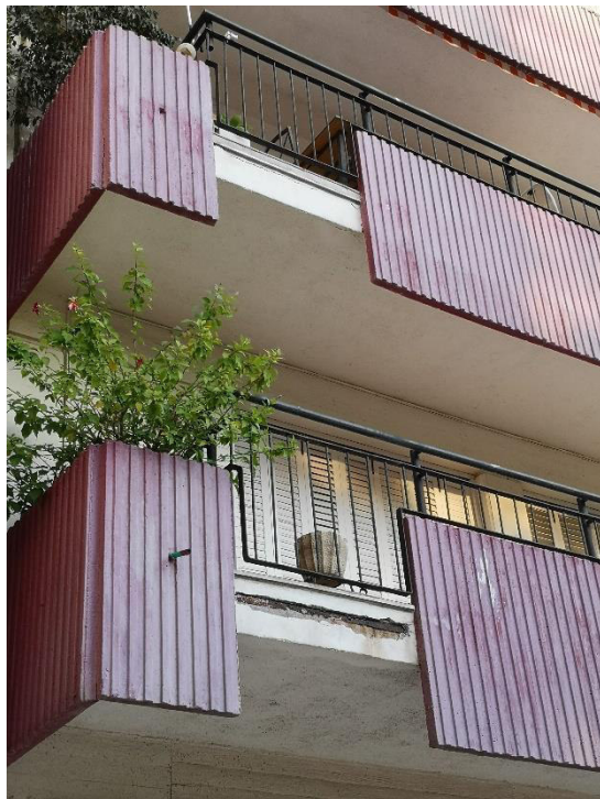
Baranes dels balcons i cantell de voladís malmès.
