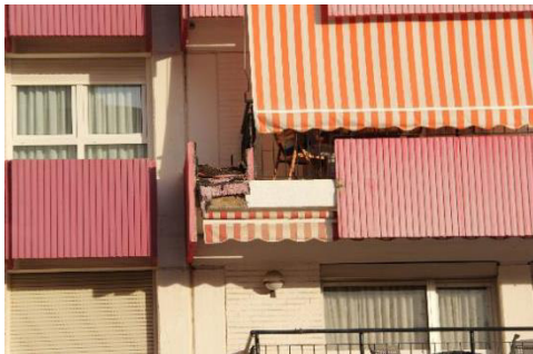
Cas en què el mal estat dels elements prefabricats de formigó ha provocat la seva total desaparició.
