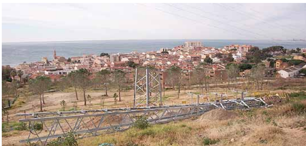
Les tasques de desviament de la línia de mitja tensió s'han finalitzat a començament del mes de març.
