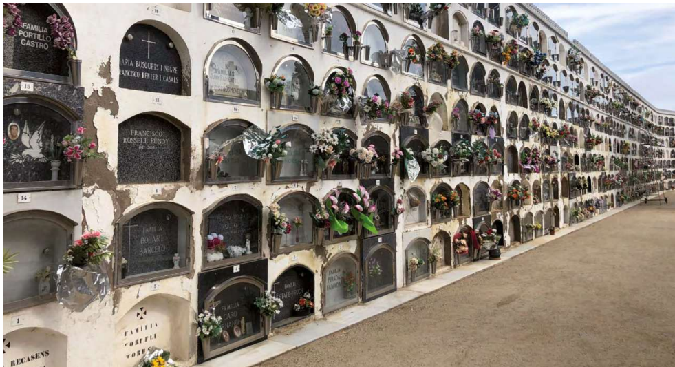
▲ Es repararan patologies provocades per filtracions i humitats. FOGO ARQUITECTES
