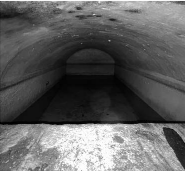
Dipòsit d'aigua de la mina Cresta. Mesures: 0,85 m d'amplada, per 3,20 m de longitud i 0,75 m de fondària. Cobert per una volta escarsera o rebaixada. Situat sota el carrer de Jaume I / Dr. Agell, al final d'una galeria de 37 metres de longitud, d'ús exclusiu per a un habitatge. Al fons s'hi pot llegir la inscripció: «Dia 24 De nobiembre de añ 1864». Foto: Rosa M. Andrés Blanch.
