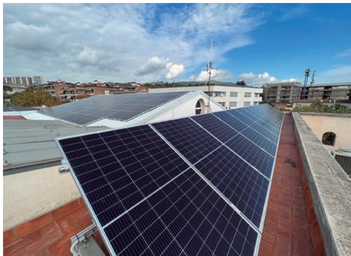
Plaques fotovoltaiques instal·lades a la coberta d'un equipament municipal.
